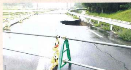
道路の陥没により通行止めとなった伊野本線
