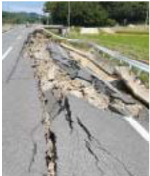
伊野本線高山橋下道路陥落
