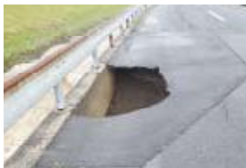
伊野本線中ノ手地内道路陥没
