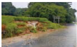
▲「8月10日畦畔崩落」
